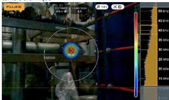
Fuite de vapeur capturée avec la caméra Fluke ii910 dans une usine de production agroalimentaire
